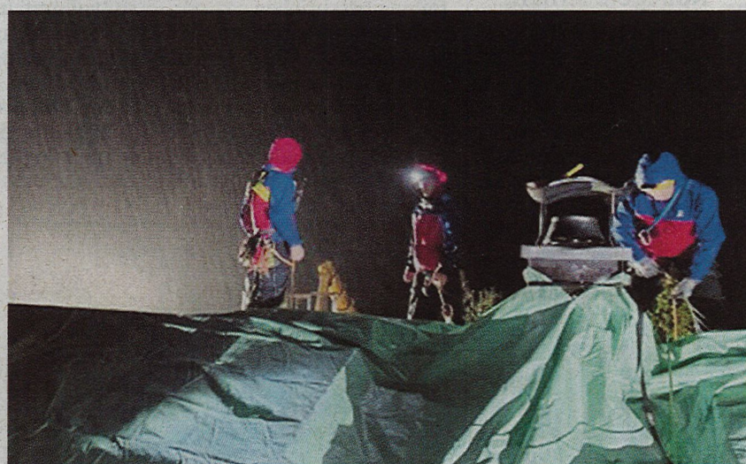
In Bad Bayersoien: Die Bergwacht half nach dem Hagelunwetter, die zerstörten Dächer mit Planen abzudichten.
