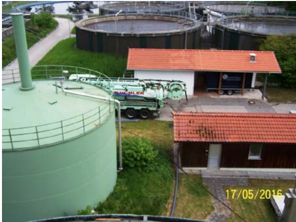
Bild 1: Entleerung des Faulbehälters in die Stapelbehälter
