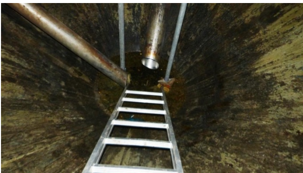
Bild 9: untere Spitze des Faulbehälters
