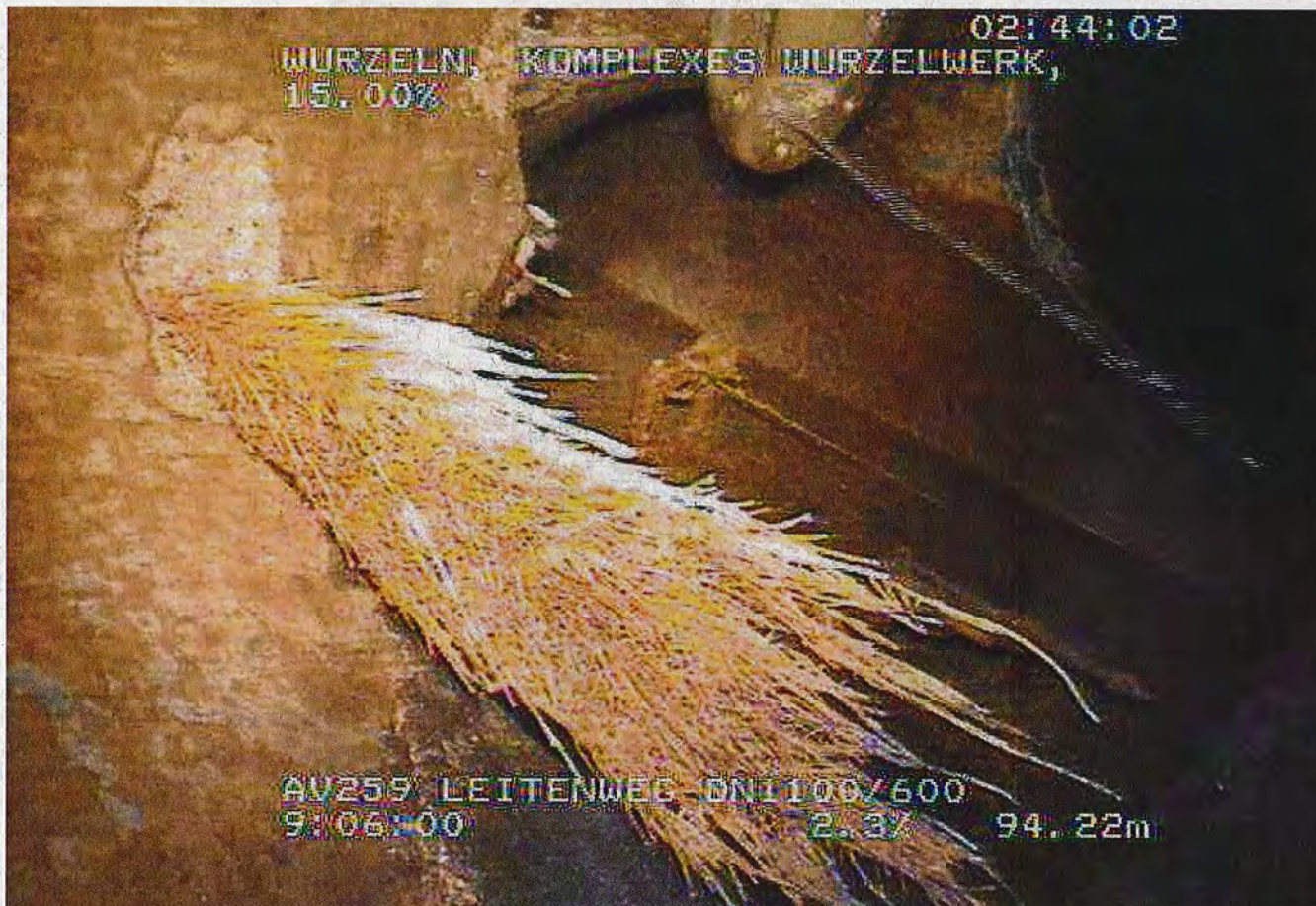
Verwurzelter Kanal: Hier am Leitenweg hat sich ein Baum den Weg zum Wasser gebahnt und dabei eine Kanalwand (links) durchdrungen.
